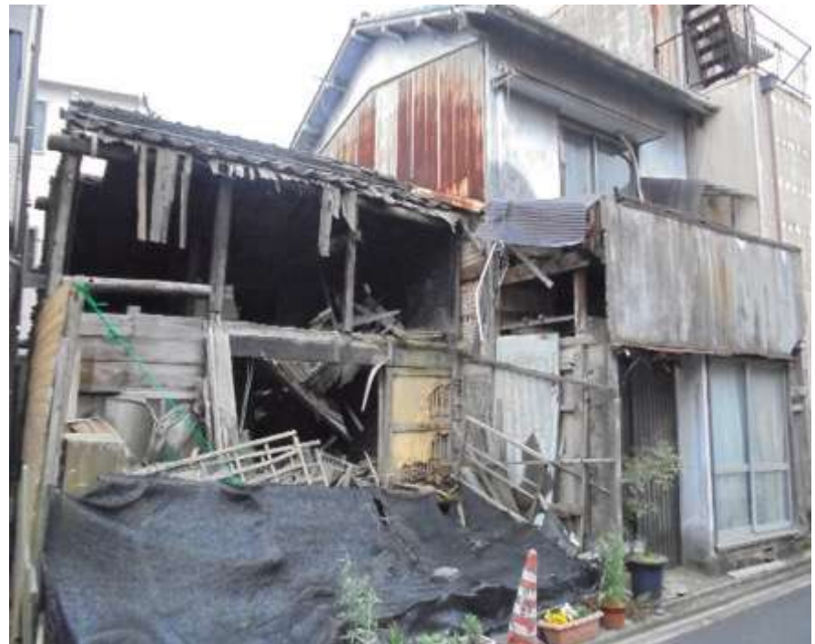
保安上危険な空き家
